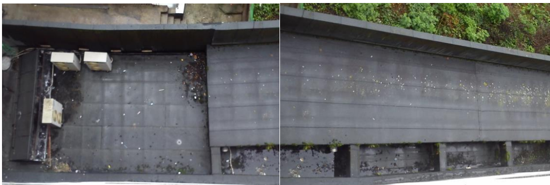
Figura 4.51 – Anomalia na cobertura de acessibilidade limitada em 2013 (foto do autor)
