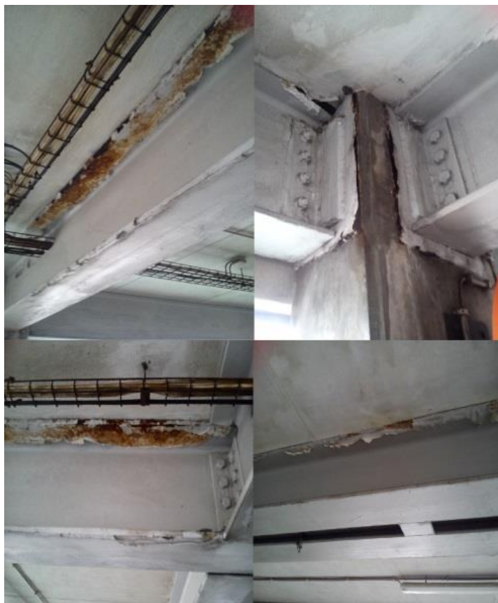
Figura 4.37 – Anomalia nas vigas metálicas do parque de estacionamento em 2013 (foto do autor)
