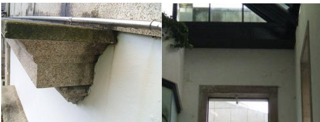
Figura 4.48 – Anomalia nas cantarias do paramento sul interior da entrada principal em 2008 (foto retirada de [26])
