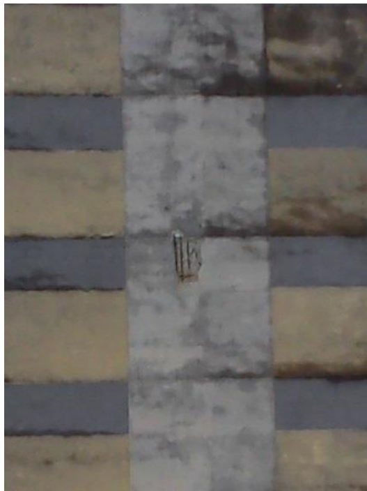
Figura 4.35 – Anomalia da fachada da caixa de escadas do parque de estacionamento em 2013 (foto do autor)
