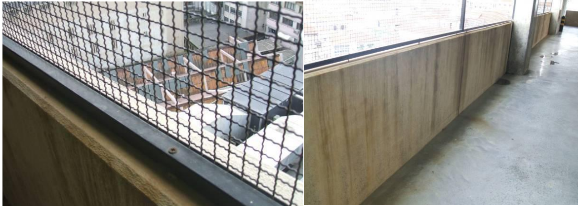
Figura 4.38 – Anomalia nas guardas metálicas do parque de estacionamento em 2008 (foto retirada de [26])
