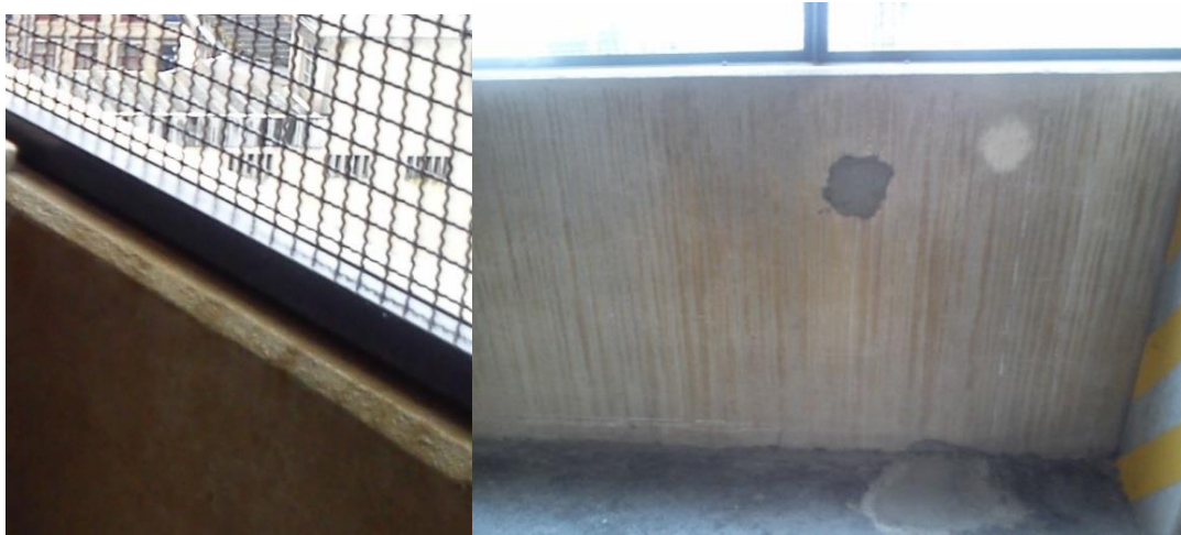
Figura 4.39 – Anomalia nas guardas metálicas do parque de estacionamento em 2013 (foto do autor)
