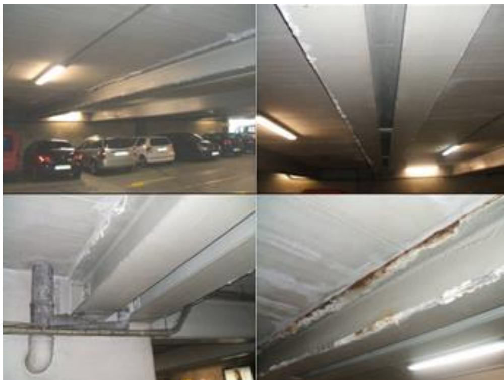
Figura 4.36 – Anomalia nas vigas metálicas do parque de estacionamento em 2008 (foto retirada de [26])
