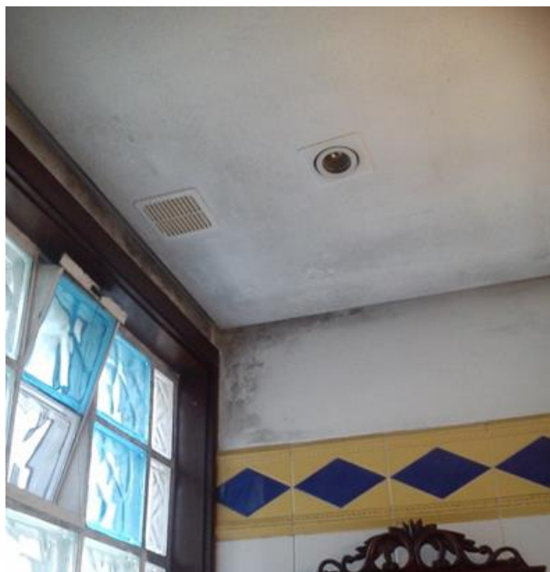
Figura 2.1 – Degradação de parede interior devido a ação de humidade (foto do autor)
