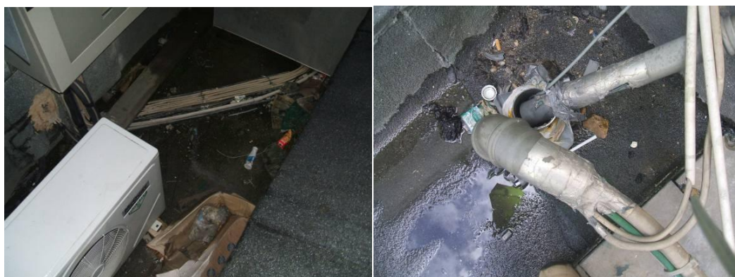
Figura 4.50 – Anomalia na cobertura de acessibilidade limitada em 2008 (foto retirada de [26])
