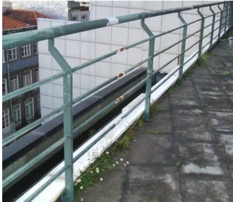
Figura 4.40 – Anomalia nas guardas metálicas da cobertura acessível a pessoas e equipamentos em 2008 (foto retirada de [26])
