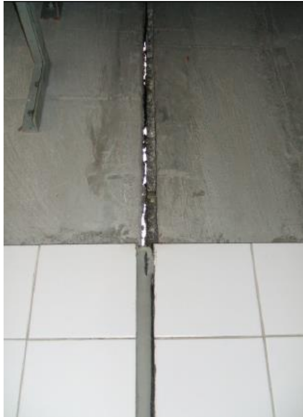
Figura 4.25 – Anomalia de uma junta estrutural em 2008 (foto retirada de [26])
