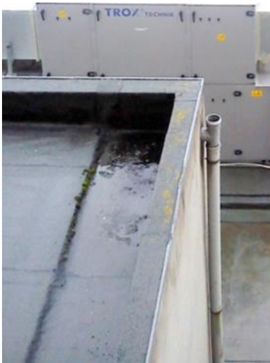
Figura 4.46 – Anomalia na cobertura de acessibilidade limitada em 2013 (foto do autor)
