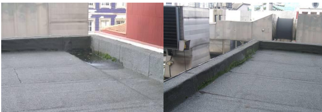
Figura 4.45 – Anomalia na cobertura de acessibilidade limitada em 2008 (foto retirada de [26])
