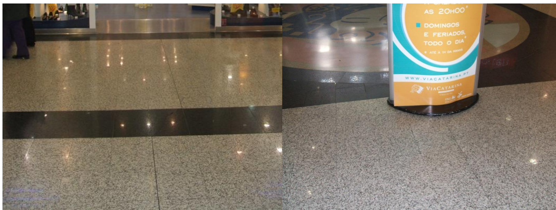
Figura 4.54 – Anomalia no pavimento do Mall em 2008 (foto retirada de [26])
