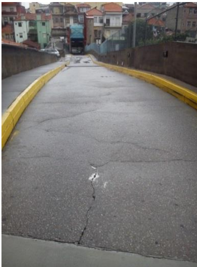
Figura 4.28 – Anomalia do pavimento da rampa de entrada do parque estacionamento em 2013 (foto do autor)
