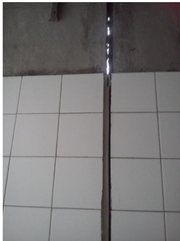
Figura 4.26 – Anomalia de uma junta estrutural em 2013 (foto do autor)
