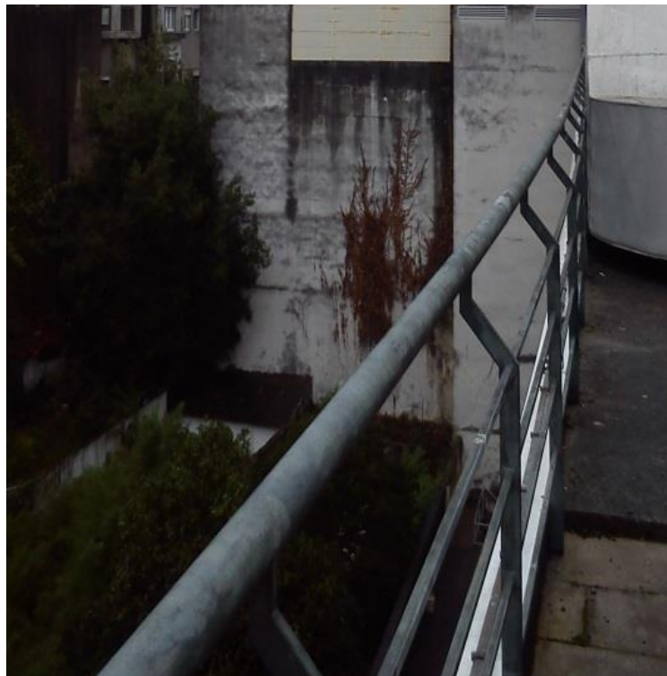
Figura 4.41 – Anomalia nas guardas metálicas da cobertura acessível a pessoas e equipamentos em 2013 (foto do autor)
