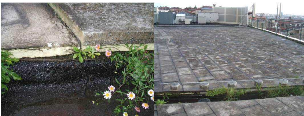
Figura 4.42 – Anomalia na cobertura acessível a pessoas e equipamentos em 2008 (foto retirada de [26])
