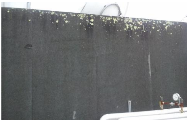
Figura 4.44 – Anomalia na cobertura acessível a pessoas e equipamentos em 2013 (foto do autor)
