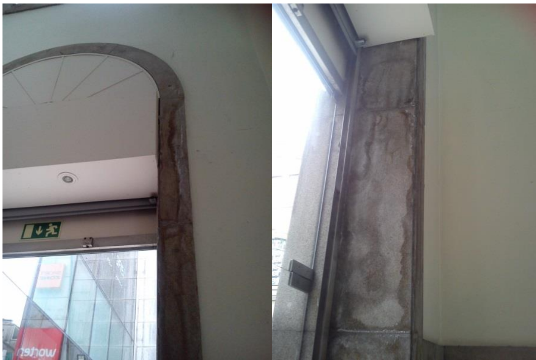
Figura 4.49 – Anomalia nas cantarias do paramento sul interior da entrada principal em 2013 (foto do autor)
