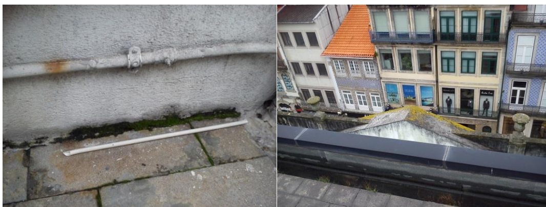
Figura 4.43 – Anomalia na cobertura acessível a pessoas e equipamentos em 2013 (foto do autor)
