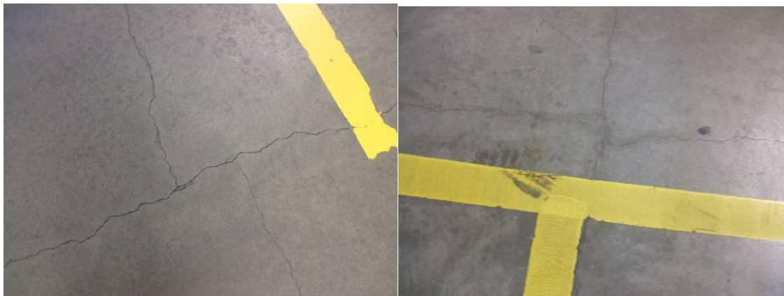
Figura 4.29 – Anomalia do pavimento parque de estacionamento em 2008 (foto retirada de [26])
