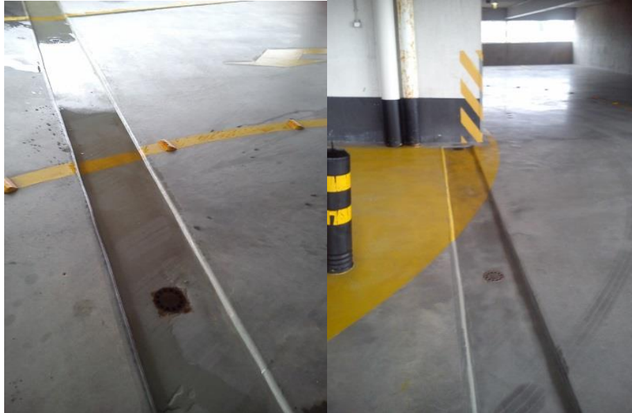
Figura 4.53 – Anomalia na caleira parque de estacionamento em 2013 (foto do autor)
