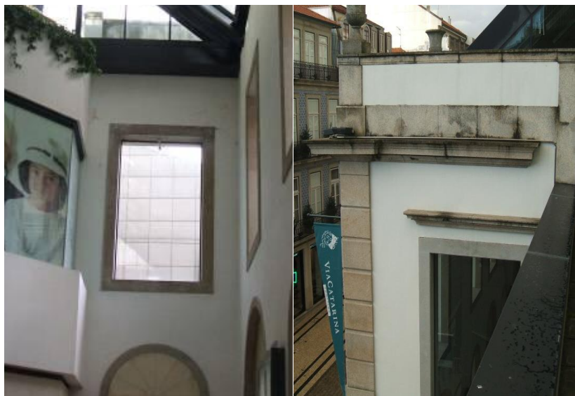
Figura 4.47 – Anomalia nas cantarias do paramento sul interior da entrada principal em 2008 (foto retirada de [26])
