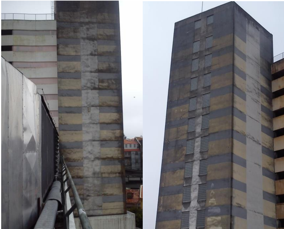
Figura 4.34 – Anomalia da fachada da caixa de escadas do parque de estacionamento em 2013 (foto do autor)
