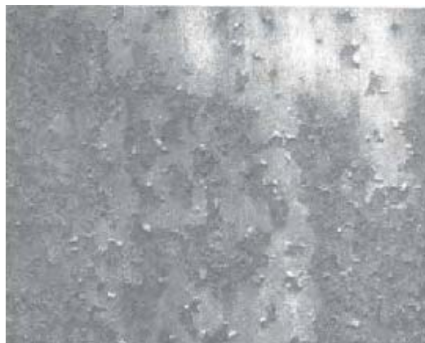
Figura 12 - Grau de corrosão Ri 5 [14].
