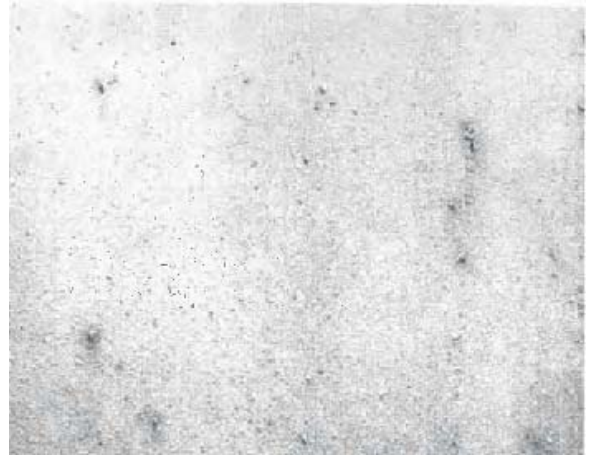
Figura 9 - Grau de corrosão Ri 2 [14].
