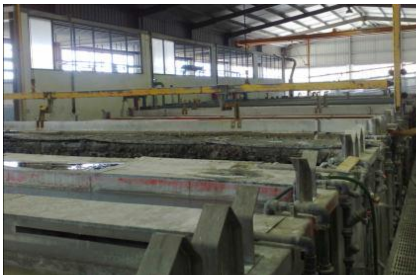
Figura 3.3: Tanques dos banhos de Anodização
