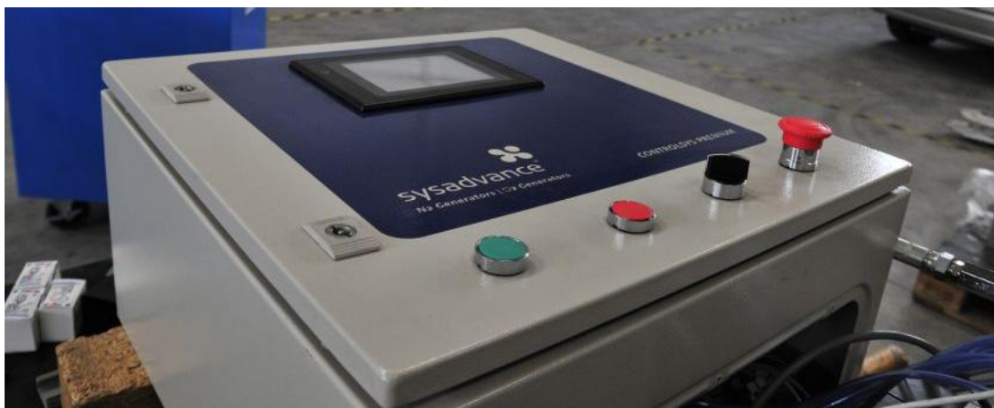
Figura 18 - Vista do armário do sistema de controlo com porta fechada
