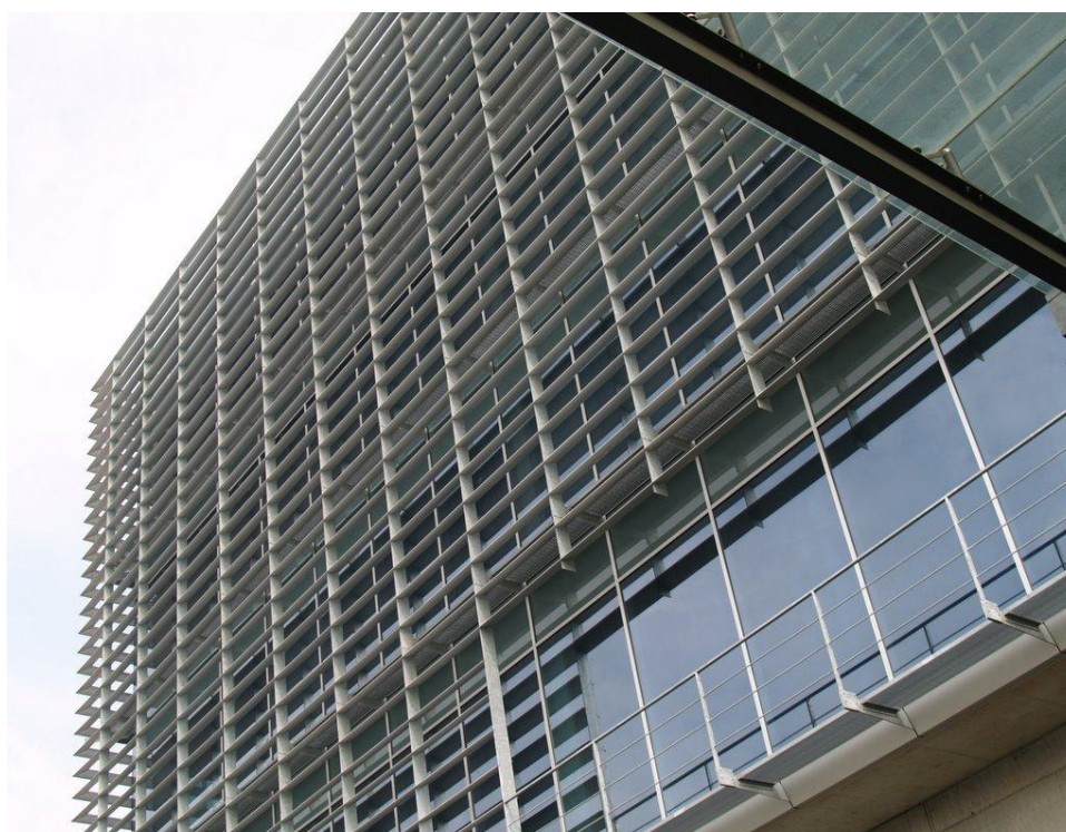
Figura 15 – Obstrutores solares instalados no edifício de Campanhã (leonardo.xavier, 2006)
