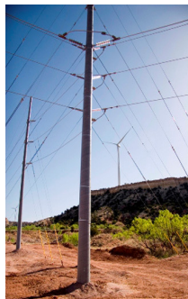
Figura 20 Poste de electricidade em GFRP fabricados por enrolamento filamental.
