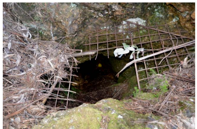
Fig. 16 - Galerias não vedadas.
