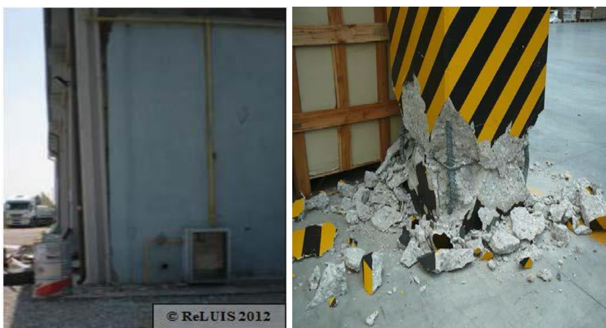
Fig.3.20 – Exemplos de a) perda de verticalidade do pilar e b) criação de rótula plástica [1]
