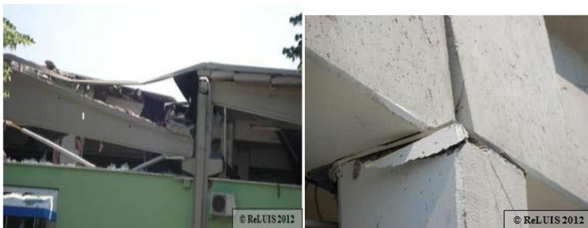
Fig.3.19 - Exemplos de a) perda de apoio e b) perda de apoio com ruptura do betão [1]
