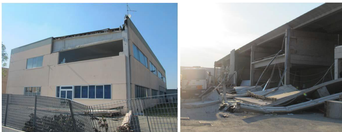
Fig.3.21. – Exemplo de ruptura de painel a) horizontal e b) vertical [1]
