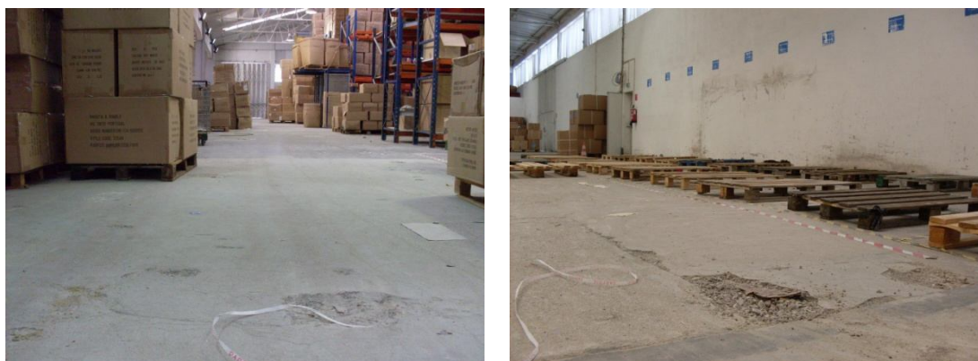
Ilustração 18 - Degradação do piso
