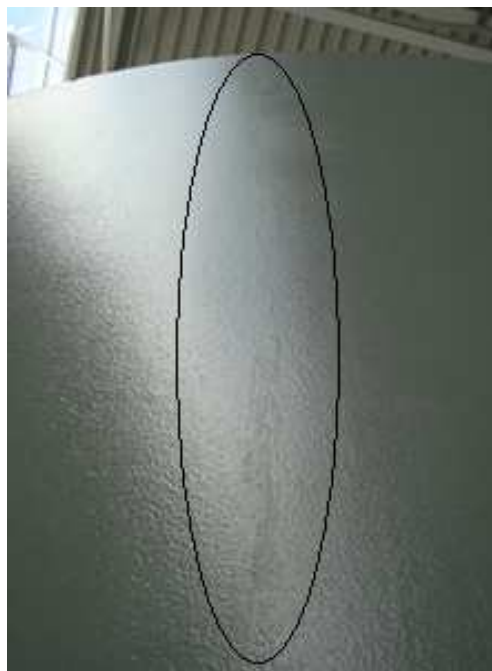
Figura 3.49 – Exemplo de má colocação da tela
