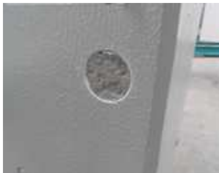
Figura 3.52 – Rotura do revestimento
