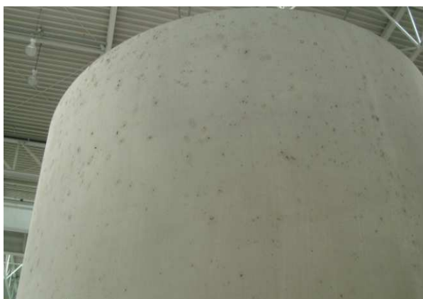
Figura 4.1 – Estado actual da superfície do betão
