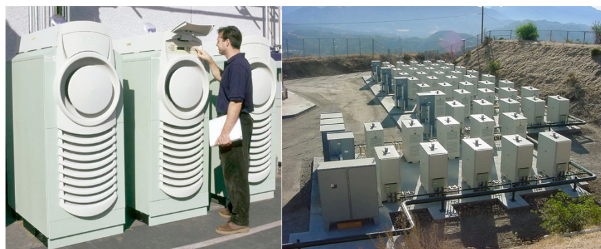
Figura 4 - Instalação de cogeração com Microturbinas (retirado de [11]).
