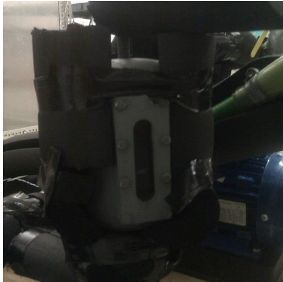
Figura 3-10: Fotografia do separador de gás-líquido usado na instalação
