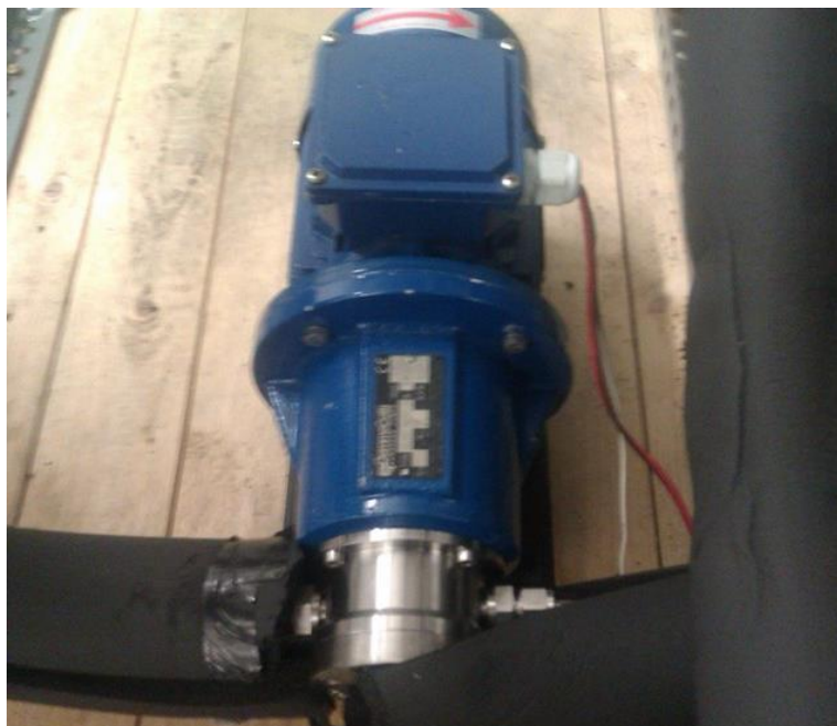
Figura 3-7: Fotografia da bomba usada na instalação
