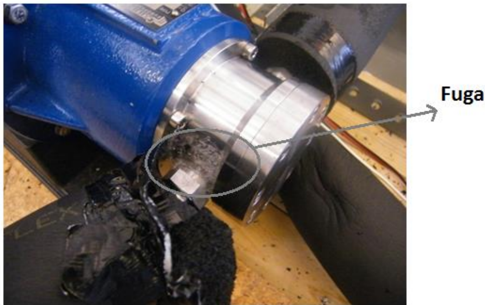
Figura 4-6: Água com sabão a reagir à fuga de gás na bomba
