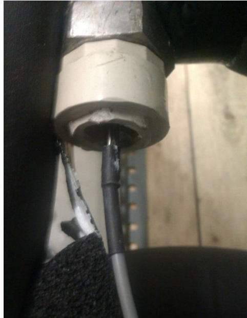
Figura 3-13: Fotografia do RTD usado na instalação na entrada do fluido refrigerante no gerador
