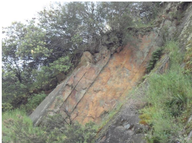
Figura 4 – Identificação de descontinuidades que podem provocar rotura planar na EN222
