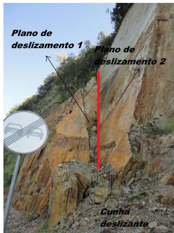
Figura 6 – Deslizamento em cunha na EN222
