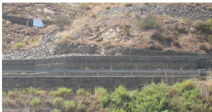
Fig. 5.3. – Fotografia de uma obra de estabilização realizada com recurso a gabiões, na EN 222
