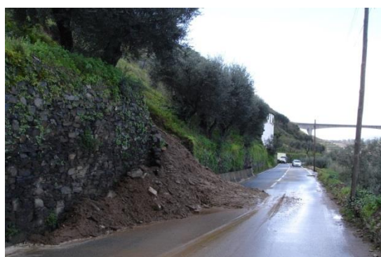
Fig. 6.3. – Derrocada parcial do muro (fevereiro 2010), [4]
