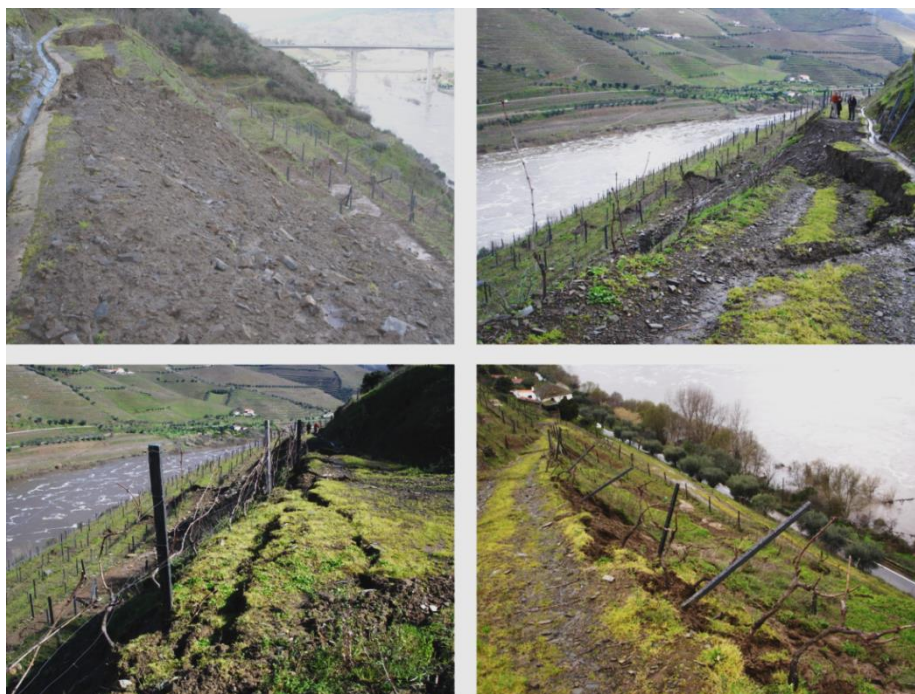
Fig. 6.2. – Deslizamentos verificados nos socalcos da Quinta de Melres (fevereiro 2010), [4]
