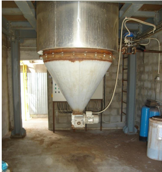
Figura 14 - Depósito para recolha de cinzas de madeira
