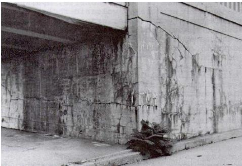
Figura 6 - Estrutura de betão afetada pela reação álcali-sílica [9]
