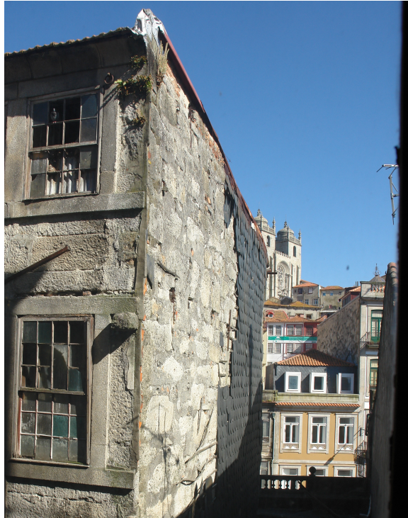
Fig. 23 – Empenas degradadas sem parte do revestimento de ardósia
