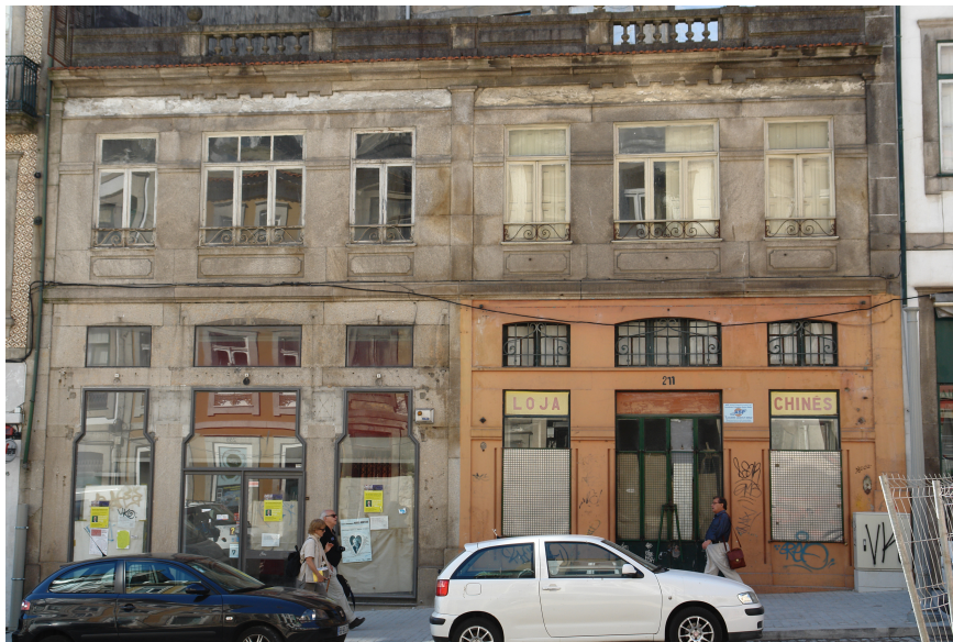
Fig. 25 – Pintura cor de laranja sobre a cantaria de granito, a remover
