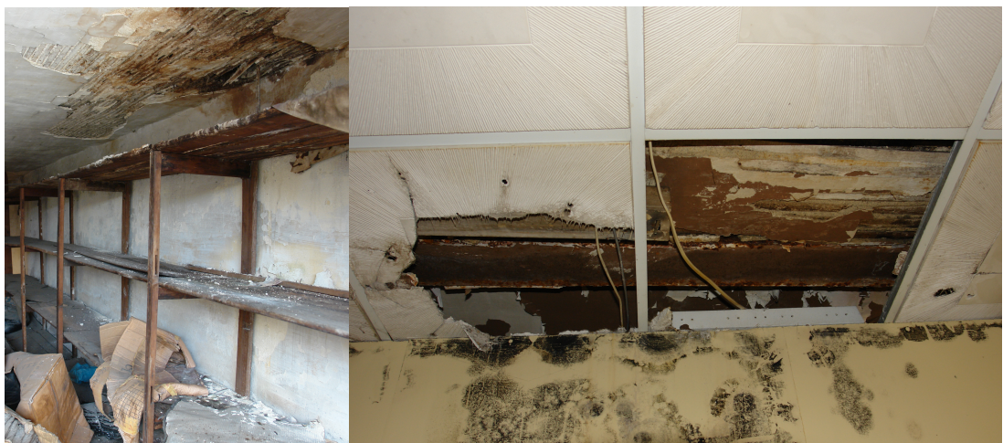
Fig. 24 – Patologias na parcela 8 que terão que ser intervencionadas
