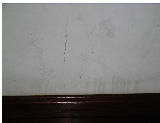
Figura 2.16 – Eflorescência provocada por humidade ascensional
