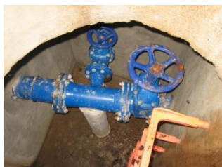
Figura 5: Caixa de Visita.
