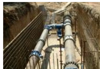
Figura 4: Troço de conduta adutora.
