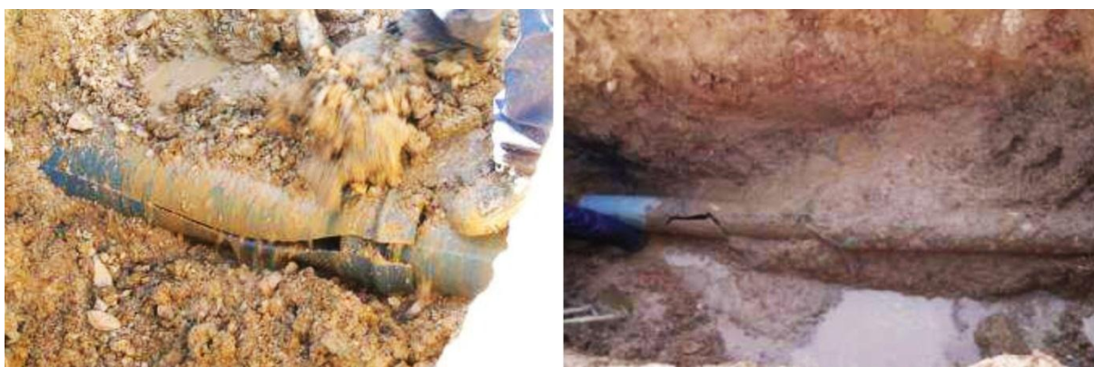
Figura 2.1 – Rotura e rebentamento de condutas por efeito do choque hidráulico (Covas, 2012)
