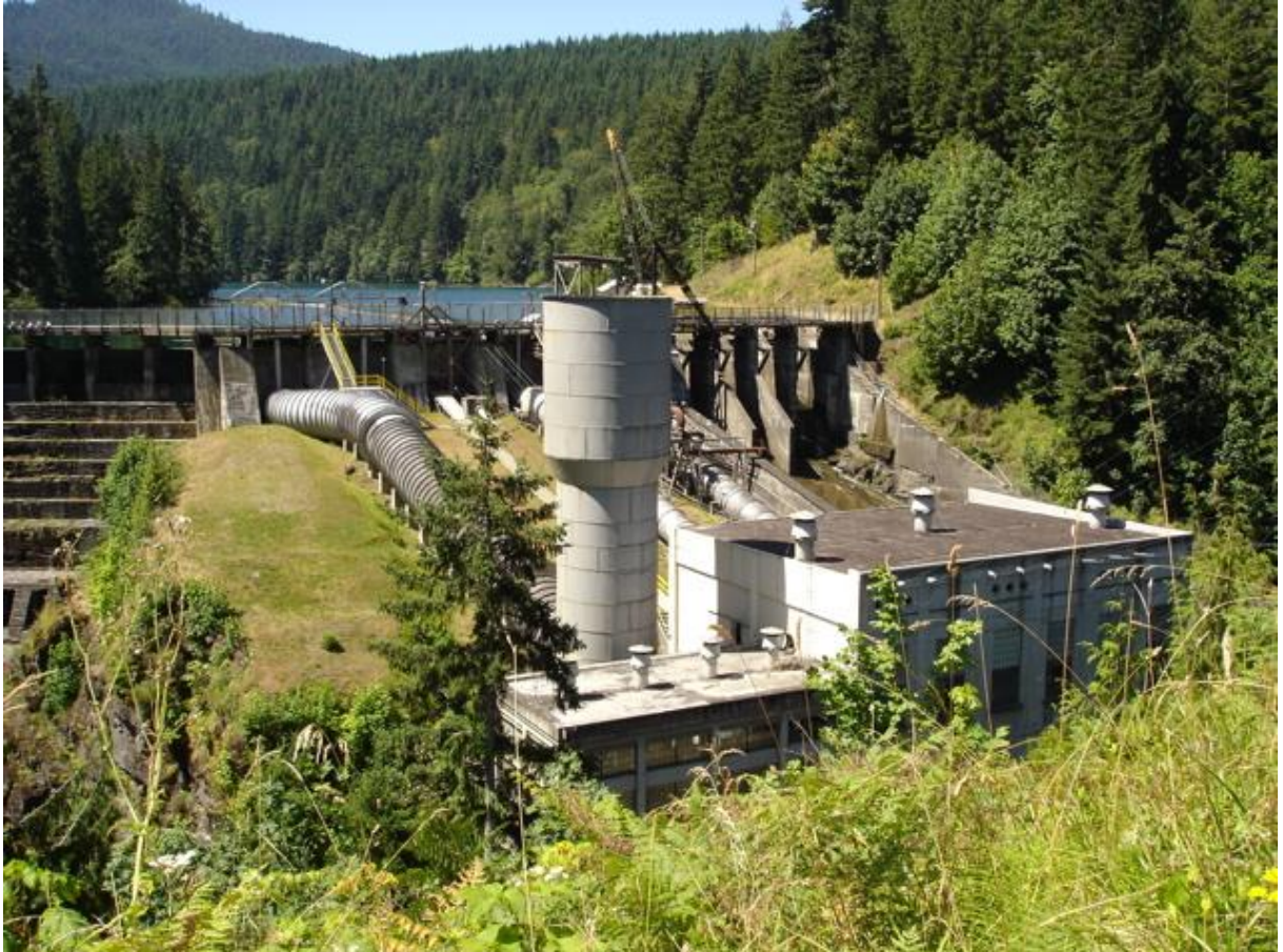
Figura 3.3 - Exemplo de Chaminé de Equilíbrio a Montante da Central (Elwa Hydroelectric Dam & Plant, EUA) [2]
