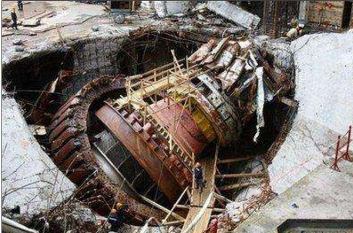
Figura 2.9 – Rotura e rebentamento de condutas num aproveitamento hidroelétrico na Sibéria Oriental devido ao choque hidráulico (Covas, 2012).
