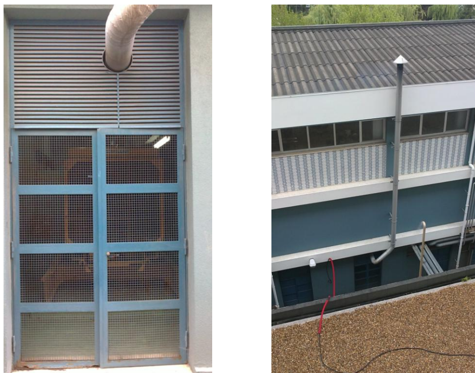
Fig. 6.37 e 6.38 – Porta em grelha em frente ao gerador e vista da varada do quarto recetor
