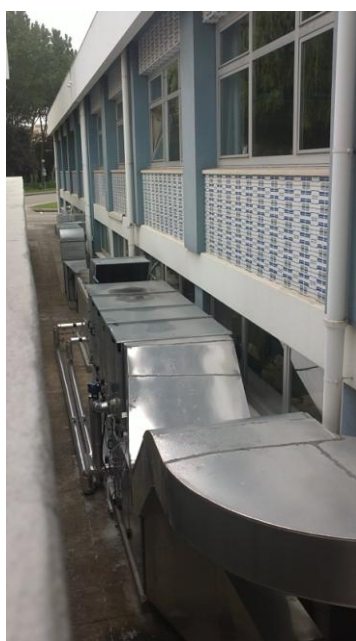
Fig. 6.33 – Equipamento de climatização fonte do ruído
