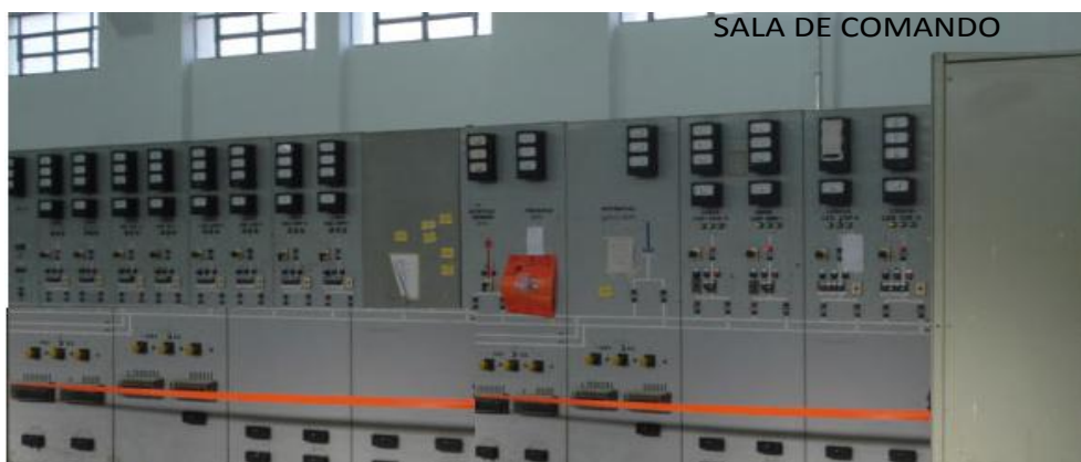
Figura 2.3 - Exemplo de sala de comando de uma subestação
