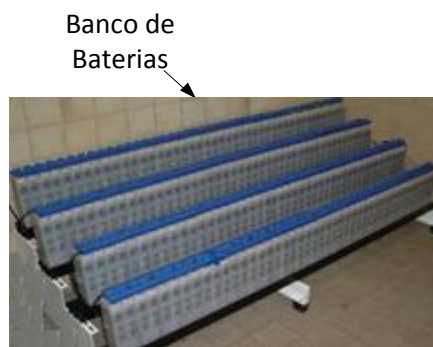
Figura 3.14 - Exemplo de sala de baterias de uma subestação
