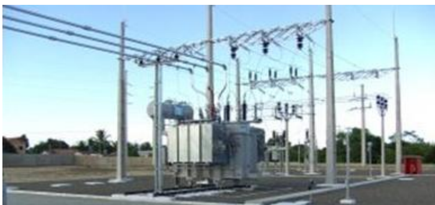
Figura 2.2 - Exemplo de pequena subestação/posto de seccionamento média tensão
