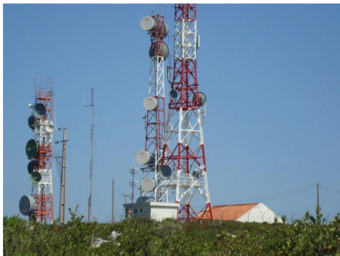
Figura 3.9 - Componentes de uma Torre de telecomunicações
