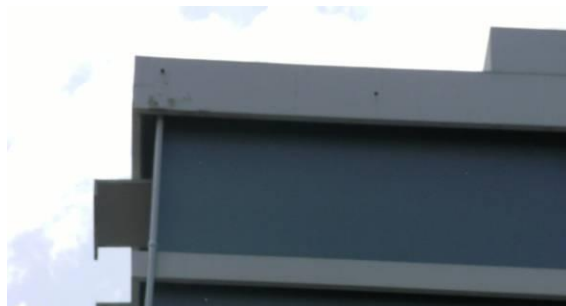
Figura 4.14 - Tubo de queda de águas pluviais
