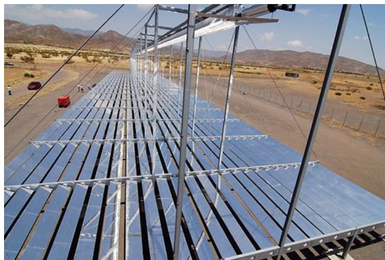
Figure 2.6 Linear Fresnel demo reflector erected on the Plataforma Solar de Almería (PSA). Source: (Plataforma Solar de Almería, 2008-2009)
