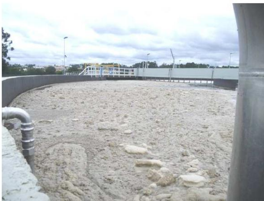
Figura 4.17. – Presencia de tensioactivos en el reactor biológico.
