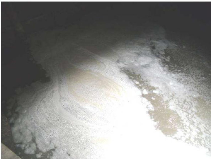
Figura 4.16. – Presencia de tensioactivos en la cámara intermedia de la elevación inicial.
