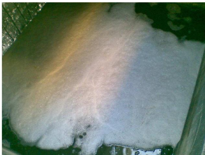
Figura 4.12. – Presencia de tensioactivos en la elevación inicial de la ETAR.
