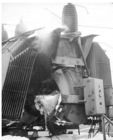
Figura 2.21 - Transformador de 100kV destruído pelo efeito das descargas atmosféricas, Holanda (1983) [6]
