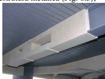
Fig. 6.3 – Placas de silicatos de cálcio resistentes ao fogo, protegendo perfil metálico, (Fonte: Serc Evolução, [47])
