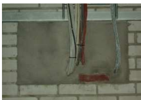
Fig. 6.6 – Ducto protegido com argamassa, (Fonte: Serc Evolução, [47])
