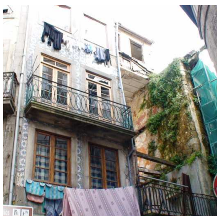
Fig. 4.14 – Pormenor da parcela 23, revestida a ladrilhos cerâmicos; e da parcela 22, visivelmente degradada
