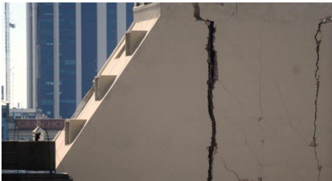
Figura 2.7 – Rotura estrutural devido a problemas geotécnicos;
