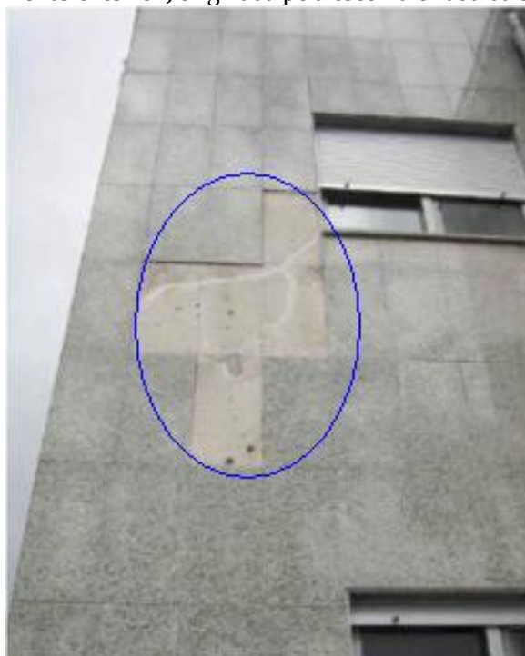
Figura 2.9 – Destacamento do revestimento exterior;
