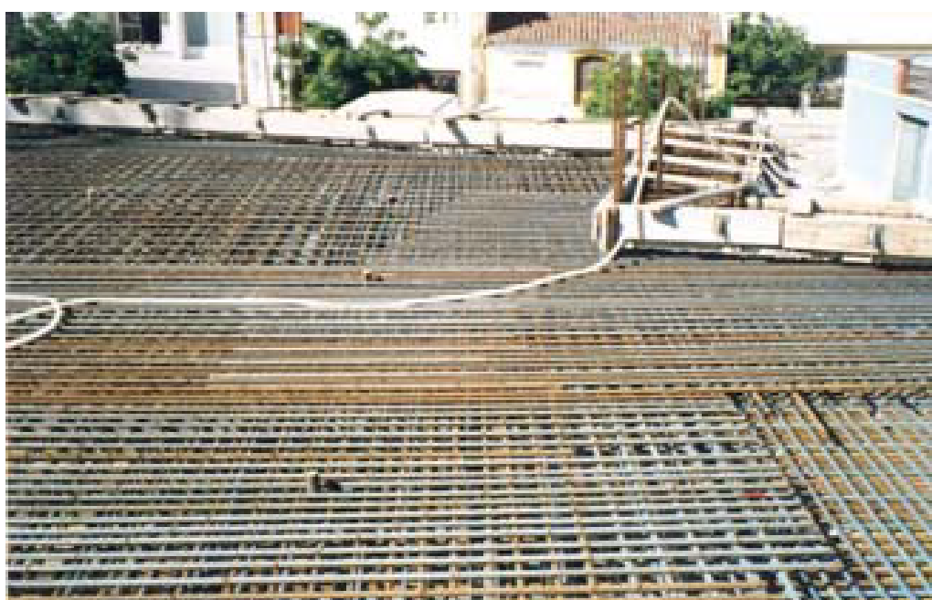
Figura 2.8 – Sobredimensionamento de armaduras;
