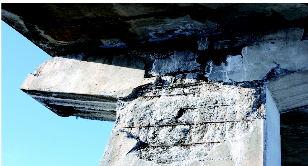
Figura 2.5 – Corrosão das armaduras em elementos de betão armado;
