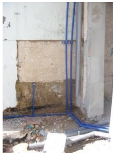
Fig. 40 – Colunas da rede de abastecimento
