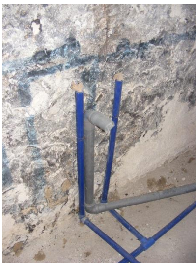
Fig. 39 – Tubagem PPR ao nível da cave
