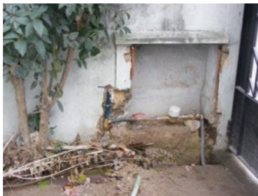
Fig. 38 – Novo contador da rede de abastecimento
