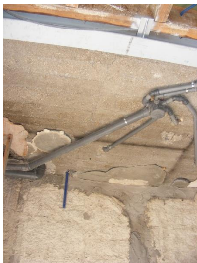
Fig. 47 – Drenagem ao nível do teto do rés-do-chão
