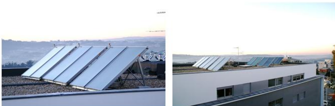
Fig. 90 – Coletores solares na cobertura de um edifício multifamiliar (adaptada de Inovafiel (2007))
