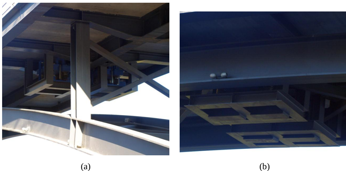
Figura 7.3 – TMDs na Ponte Pedonal da Rabada para controlo do 1º modo (a) e do 3º modo vibração (b)
