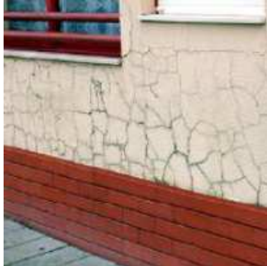
Fig.3.1 – Exemplo de fissuras. [16]
