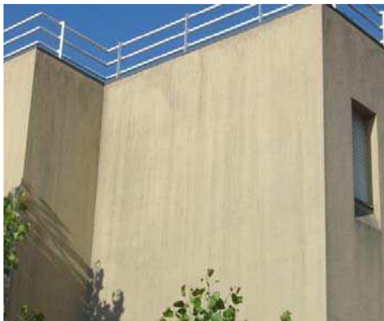
Fig.3.3 – Sujidade na fachada. [13]
