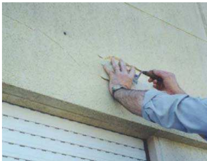
Fig.3.2 – Destacamento do revestimento. [13]
