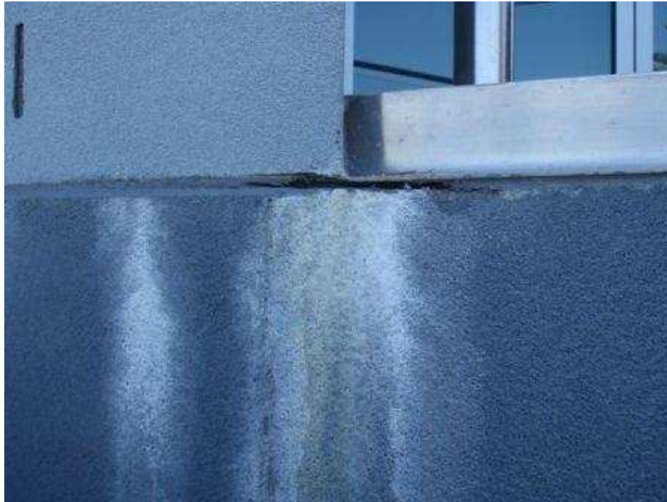
Fig.3.4 – Exemplo de efflorescência. [18]
