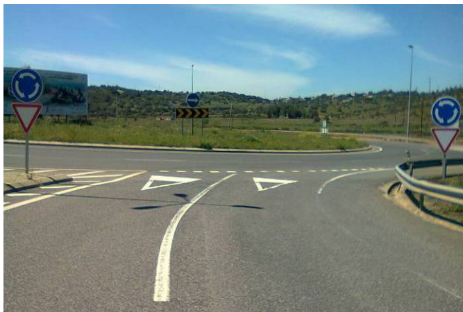
Figura 124 – Linha de cedência de passagem (M9a/LBTc) entrada da rotunda – N124 – Portimão
