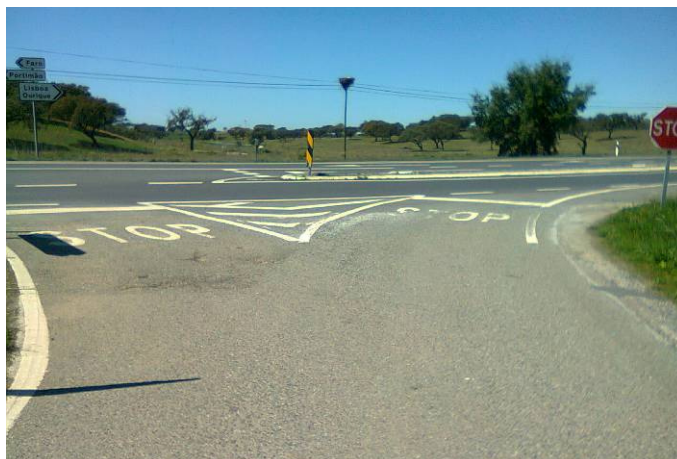
Figura 57 – Via secundária com movimento de viragem à direita incorretamente sinalizado com sinal B2 e marca no pavimento – IC1 – Messines
