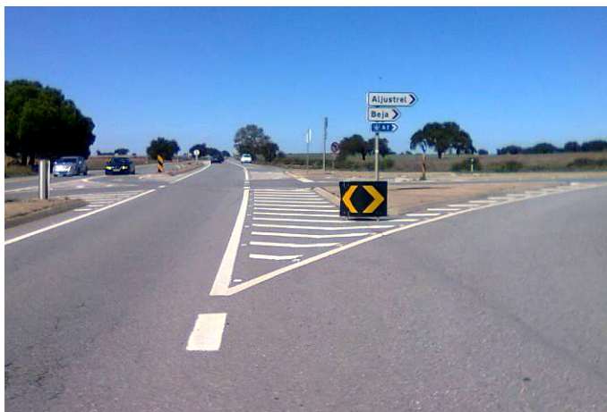
Figura 89 – Utilização incorreta da baliza O5b para balizamento de ponto de divergência em interseções de nível – IC1
