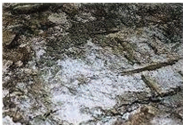
Figura 2.9 – Ataque de sulfatos numa laje [36].
