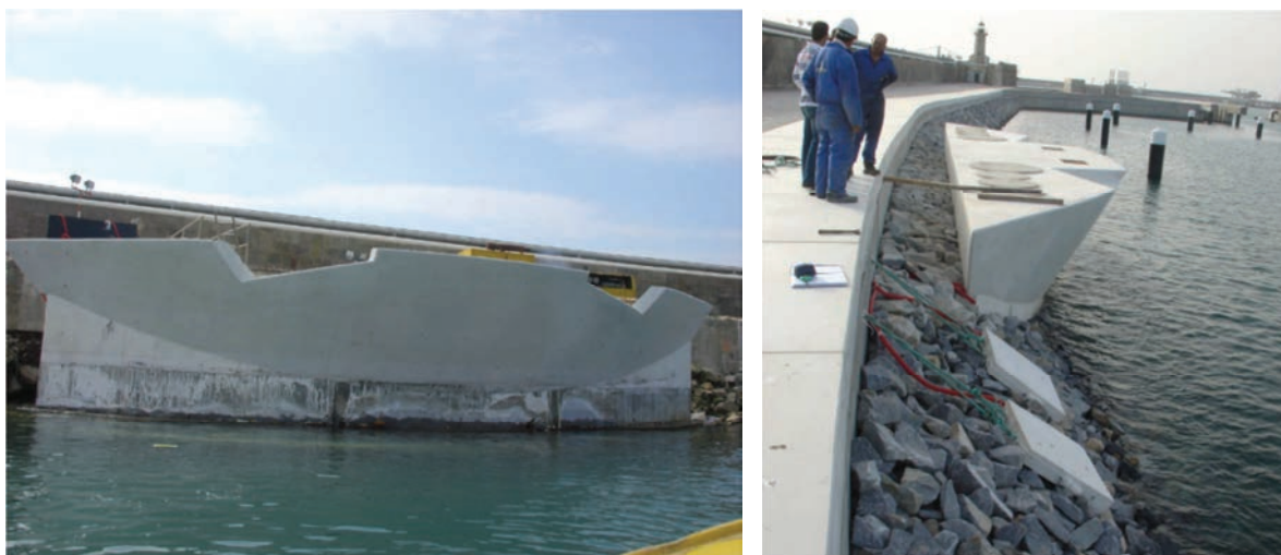
Figura 7.3 e 7.4 – Elemento em BAC branco da “Ilha Ecológica” do Porto de Recreio, em Leixões.
