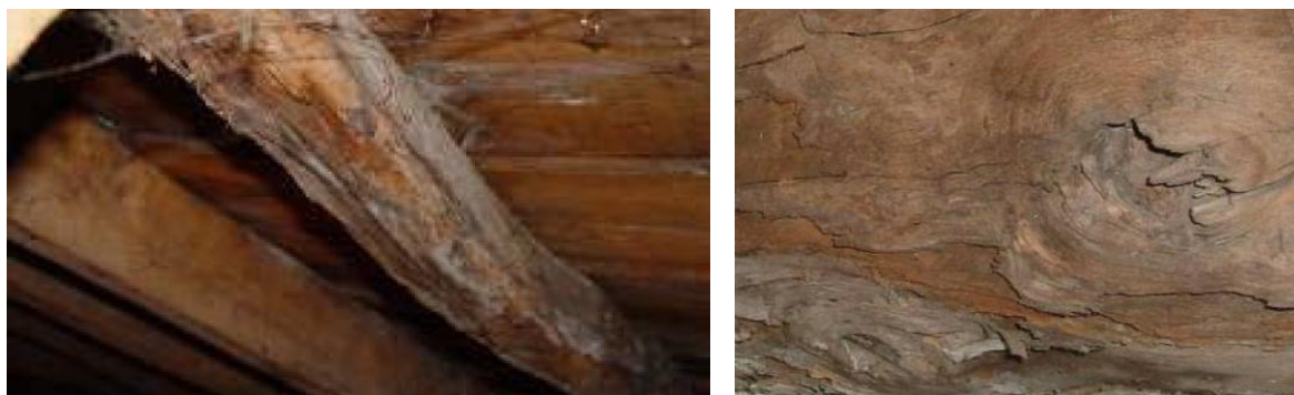
Figura 4.1. – Danos locais: a) viga de pavimento excessivamente deformada [Lourenço, 2007]; b) nós em vigas de pavimentos [Dias, 2008]
