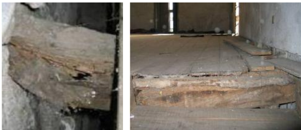
Figura 4.2. – Danos globais: entrega de viga muito degradada e deformação profunda do pavimento [Delgado et al , 2007]
