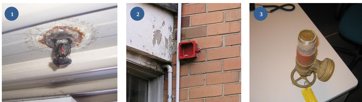
Figura 3.8 – 1) Sprinkler danificado; 2) Alarme de emergência inexistente; 3) Boca de hidrante bloqueada com lama.
