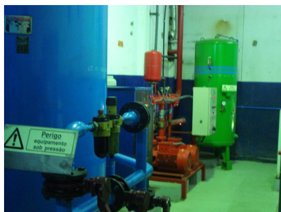
Figura 5.3 – Grupo de bombagem e compressor.
