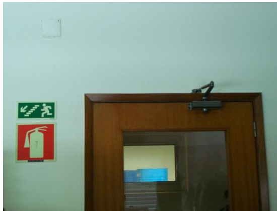
Figura 5.4 – Sinalização mal posicionada.
