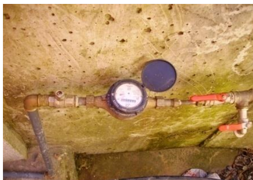
Figura 5.1 - Contador de água
