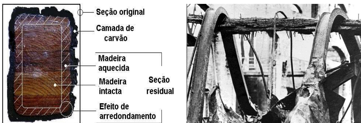
Figura 2.5 e 2.6 À esquerda, seção de uma viga de madeira exposta ao fogo durante 30 minutos; À direita, aspeto de Vigas de madeira e aço, após incêndio
