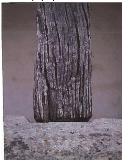
Figura 3.7 Exemplo dos danos causados por fotodegradação numa peça de madeira (Arriaga et al; 2002)
