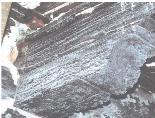
Figura 2.7 Cachorro de madeira após incêndio (Tampone;2000)
