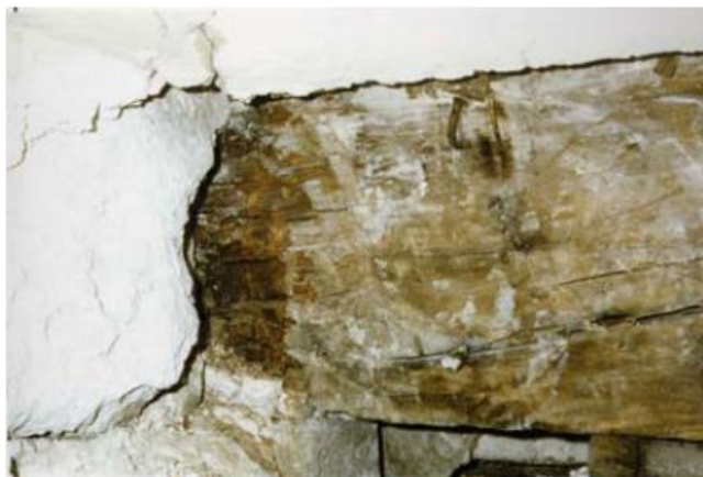
Figura 3.9 Deficiente estado de conservação da madeira de uma viga com o apoio devido a humidade elevada e falta de ventilação (Feio;Lourenço;2005)
