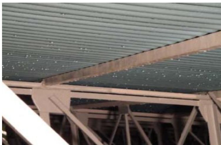
Fig 5.14 – Presença de água no estado líquido no tardo do sistema de revestimento devido ao fenómeno de condensação [31]
