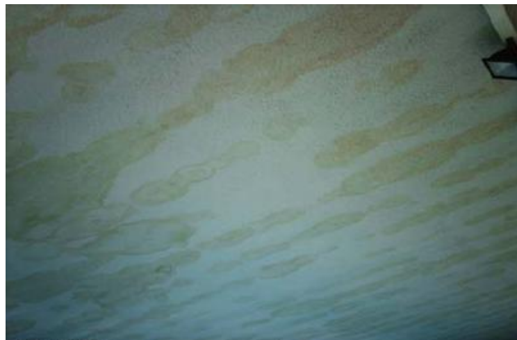
Fig 5.13 – Manchas de humidade no teto da nave da piscina [31]
