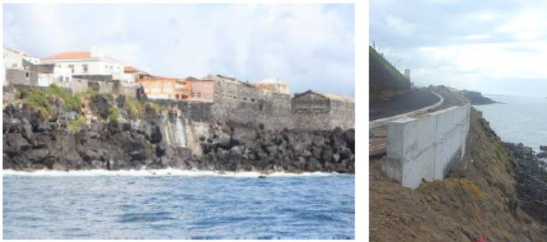
Fig. 3.36 – Aspeto geral da arriba e pressão urbanística local (Feteiras, Ponta Delgada) e estrada com localização inadequada e muro de suporte em terreno instável (POOC São Miguel, Costa Sul).
