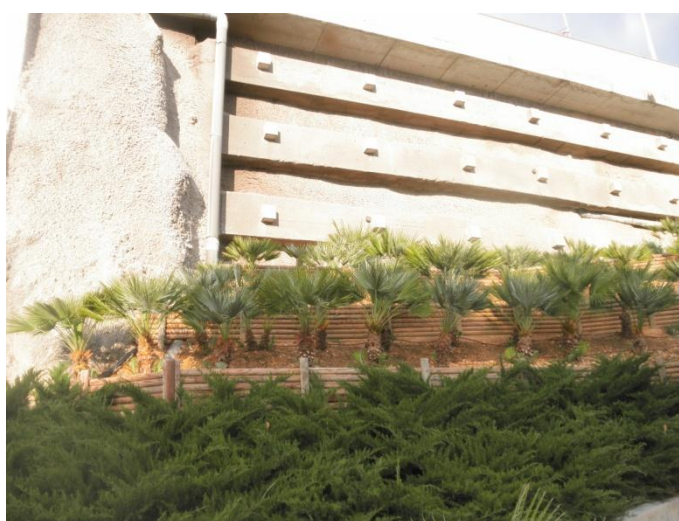
Fig. 4.15 - Praia de Albufeira nascente (Algarve). Proteção da arriba com betão projetado, ancoragens, estrutura vigada de betão armado e estruturas de madeira constituindo plataformas com vegetação.
