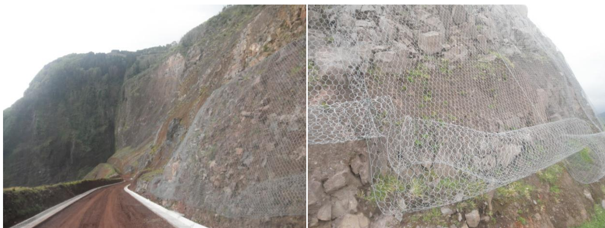
Fig. 4.18 – Rede de proteção em arriba no acesso à Fajã do Calhau, S. Miguel, Açores.
