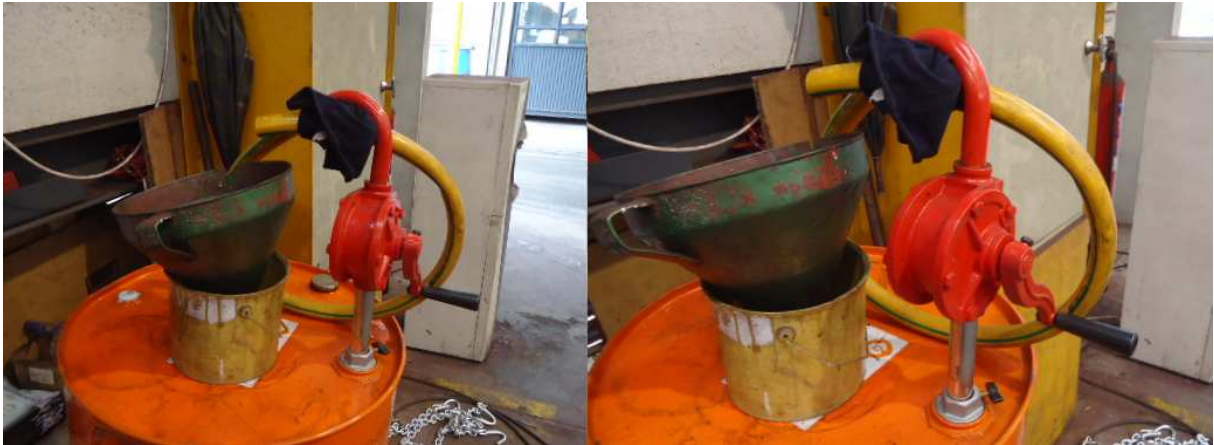
Figura 31 - Bomba de óleo
