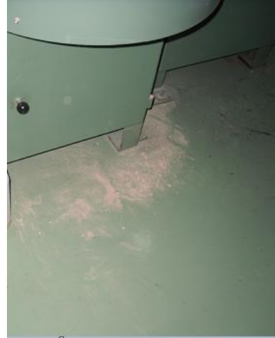
Figura 27 - Área da marcação - situação encontrada.
