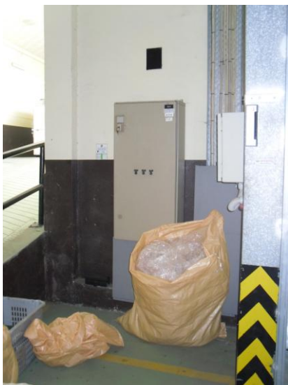
Figura 31 - Quadro elétrico da fábrica - Antes.
