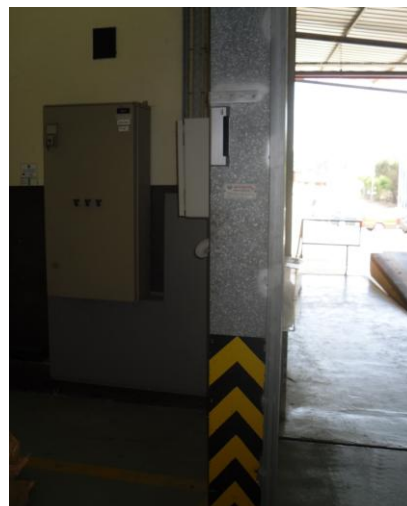
Figura 32 - Quadro elétrico da fábrica - Depois.
