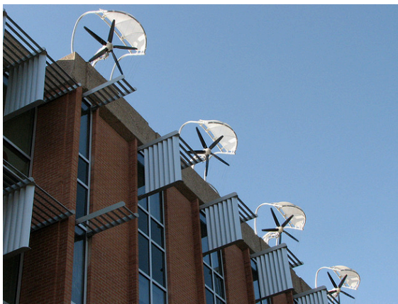
Fig. 2.57 – Energia Eólica em Telhados [46].
