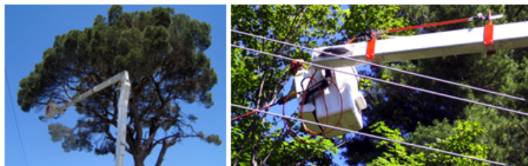
Figura 3.17: Trabalhos em altura realizados muito próximos da linha.
