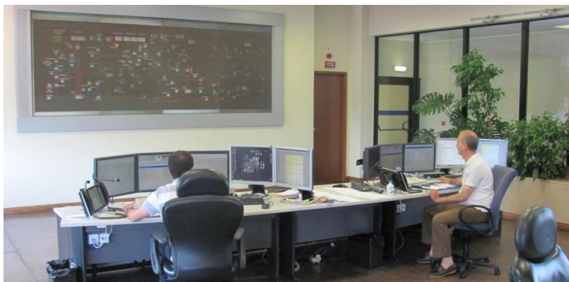
Figura 2.2 - Aspeto geral da sala do Centro de Operação da Rede, Vermoim
