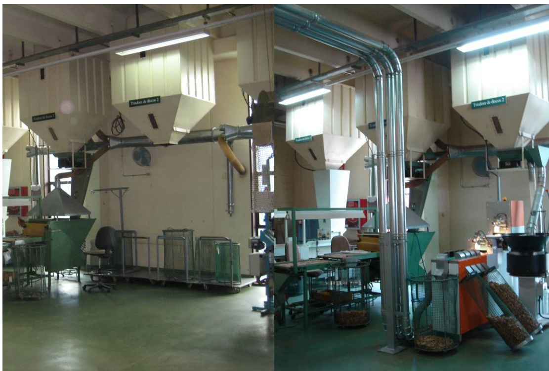
Figura 17 - Instalação da máquina de escolha electrónica por raios laser
