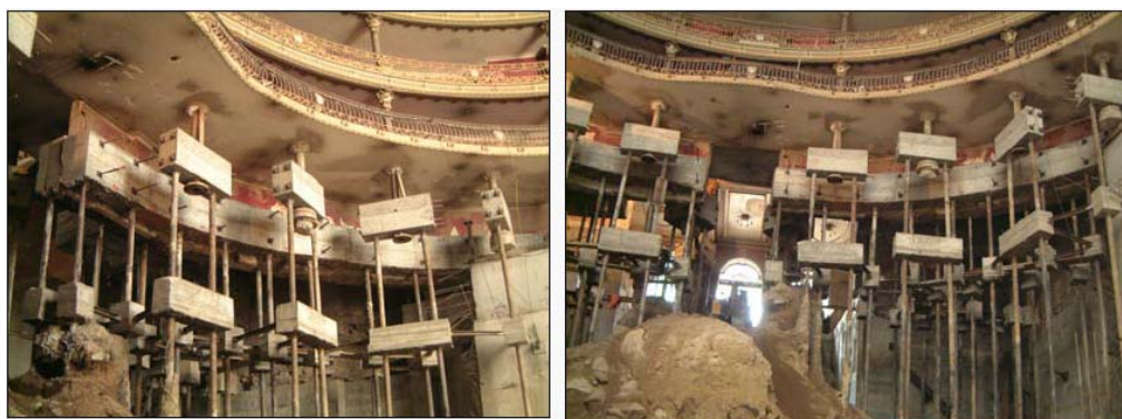
Figura 22: Vistas do recalçamento dos pilares e das paredes onde apoiam os balcões no Teatro Circo de Braga (Pinto et al., 2004a)
