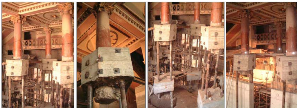
Figura 23: Fases do recalçamento dos pilares localizados na entrada principal do Teatro Circo de Braga (Pinto et al., 2004a)
