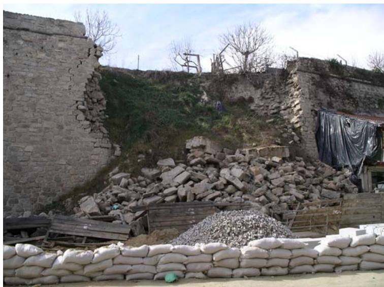
Figura 34: Muralha de Chaves – Baluarte do Cavaleiro - após o 2º desmoronamento
