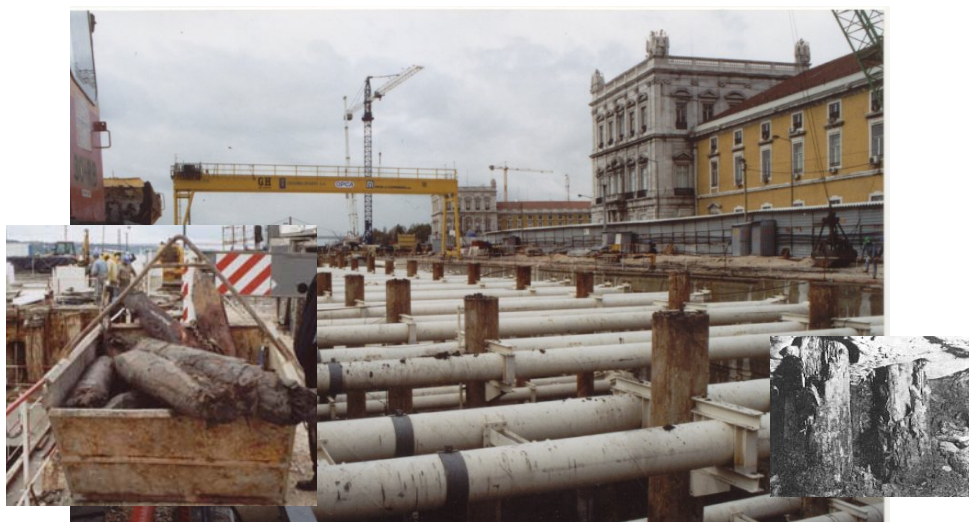
Figura 14: Apodrecimento de estacas de madeira (ex.: Terreiro do Paço em Lisboa)
