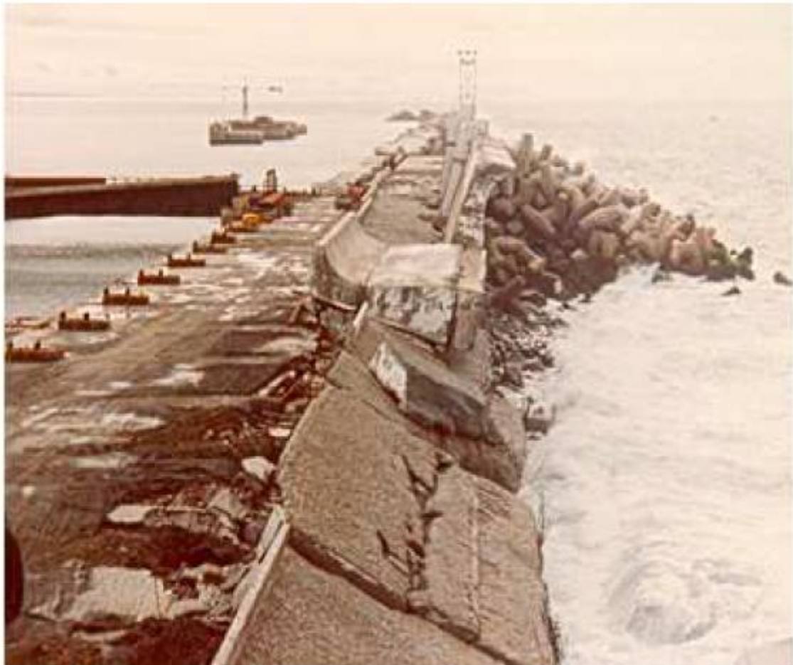
Fig. 20 - Colapso do manto de proteção e da superestrutura do molhe Oeste do Porto de Sines, 1979. [3]
