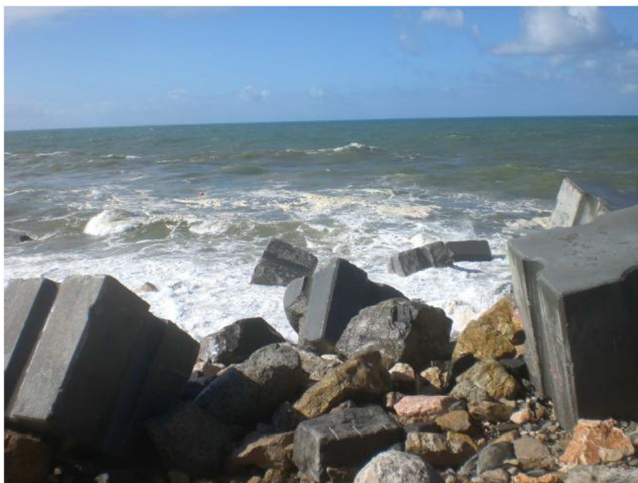
Fig. 11 - Blocos Antifer deslocados na zona da cabeça do molhe, 2009. [4]
