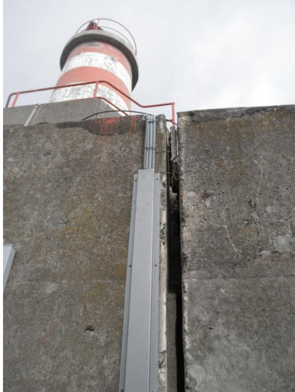
Figura 2.38 – Quebramar do porto do Funchal, junta de dilatação, mostrando sinais de instabilidade na zona da cabeça, 2011.
