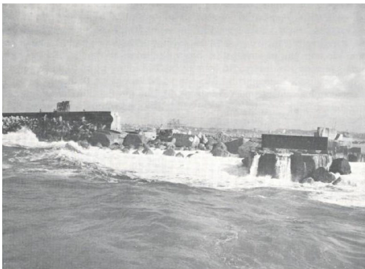
Fig. 16 – Estragos na cabeça do quebramar norte devido às fustes tempestades, anos 70. [5]
