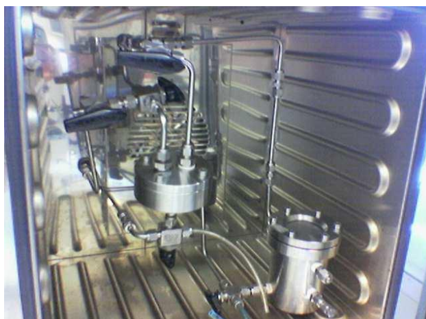
Figura 3.3- Instalação do reactor de membrana.
