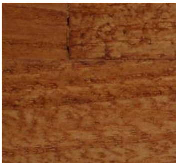
Figura 6A.3 - Não uniformidade de cor verificada no Castanho após aplicação de Vel. Aq.
