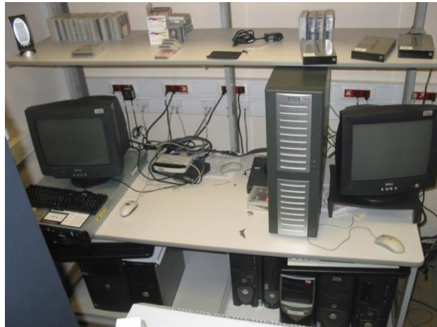
Figura 16 Fotografia da bancada de servidores do pólo técnico do Porto
