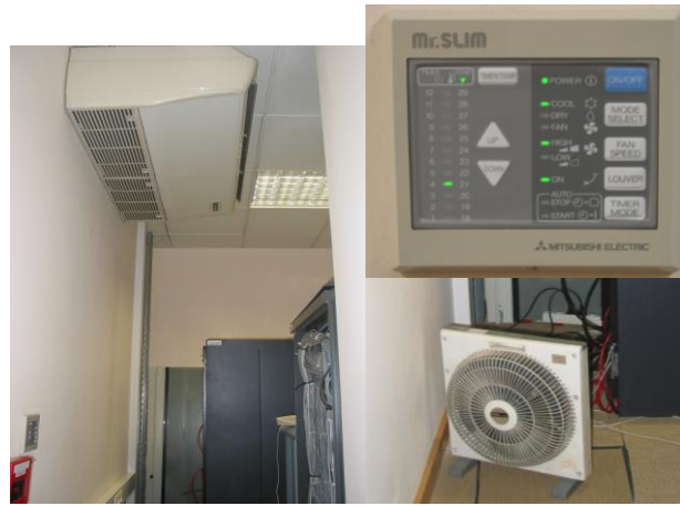
Figura 14 Fotografias do sistema de ar condicionado do pólo técnico do Porto
